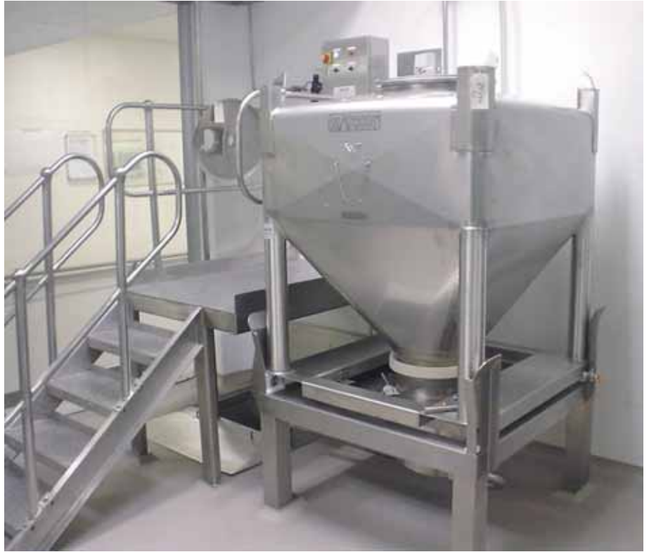
IBC 洗浄ステーション
